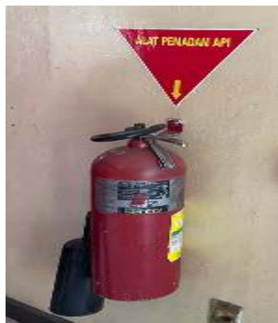
Gambar 3. APAR di Kantor Luar Pabrik
